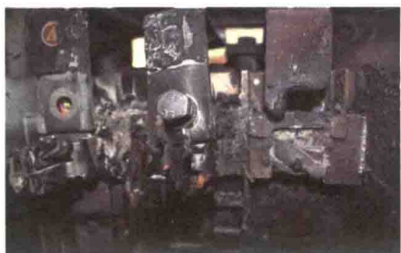
图 9 上静触头烧蚀情况
