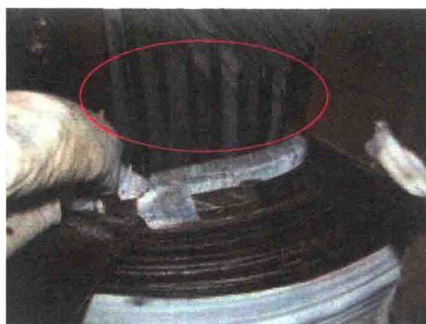
图 2 变压器上端固定情况
