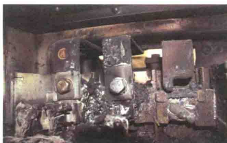
图8 烧毁的C相开关进线
