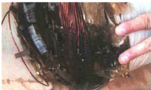
图 7 B 相高压绕组底部放电点
