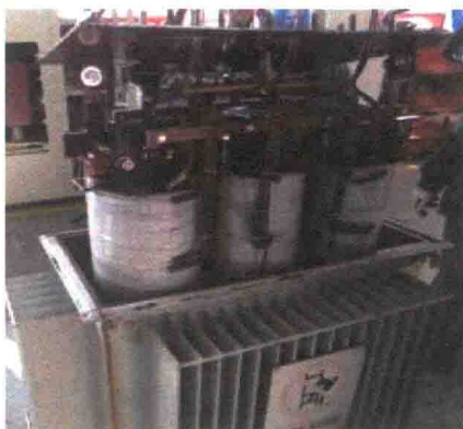
图 3 变压器铁芯锈蚀
