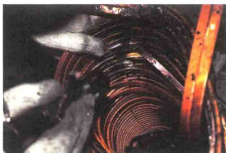
图5 B相低压绕组烧断位置
