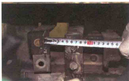
图 15 出线开关内部与母线连接处
