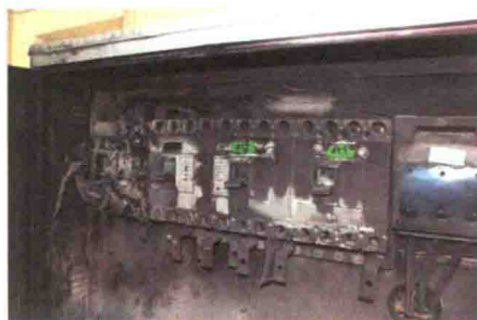
图 14 出线开关内部
