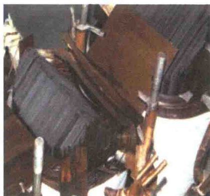
图 4 高压绕组上端层间绝缘纸条折断
