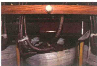
图 2 变压器 B 相低压绕组发生位移
