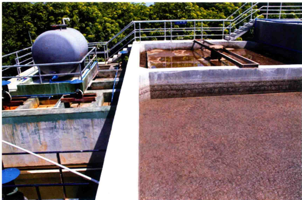
图 1-2-1 废水处理设施
