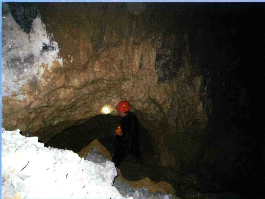
隧洞超前预报预测的岩溶管道开挖揭露情况
