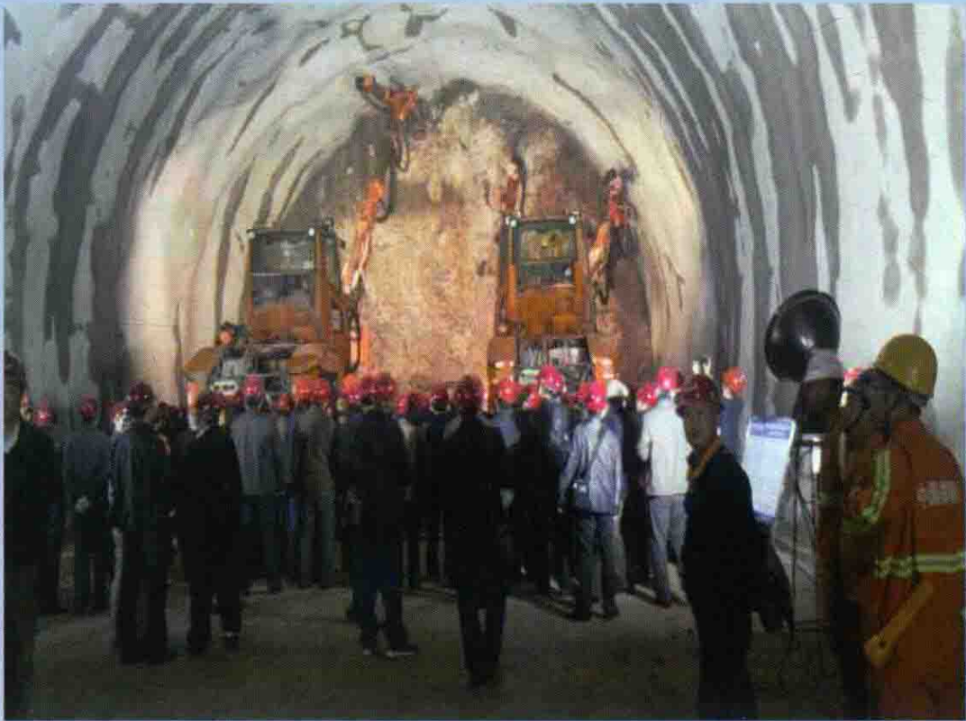
隧洞洞顶塌方现场工作会
