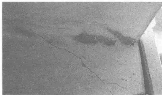
图 1-15 压力过大造成的裂缝
