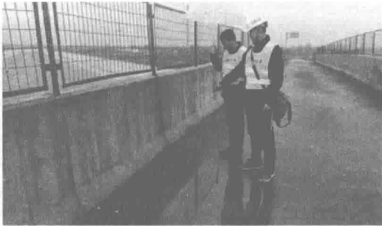
图 1-12 泄水管堵塞桥面积水
