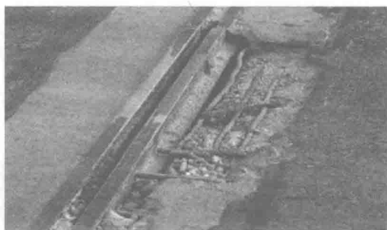
图 1-7 伸缩缝附近混凝土破损
