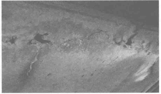
图 1-24 梁体底板锈蚀病害
