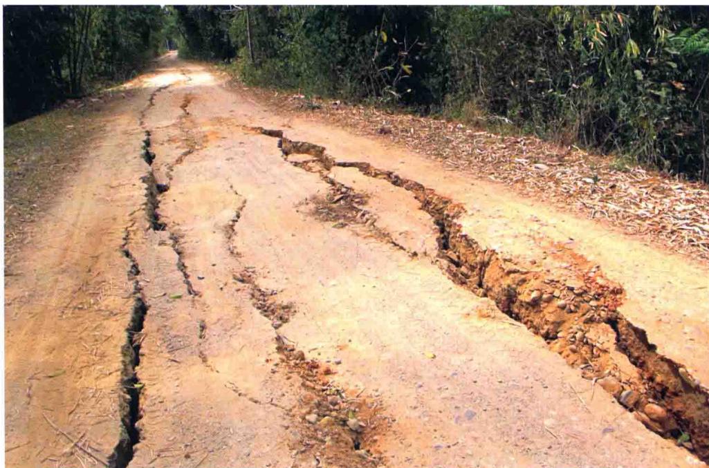
图 1-4-7 盈江河堤路面开裂和下沉
