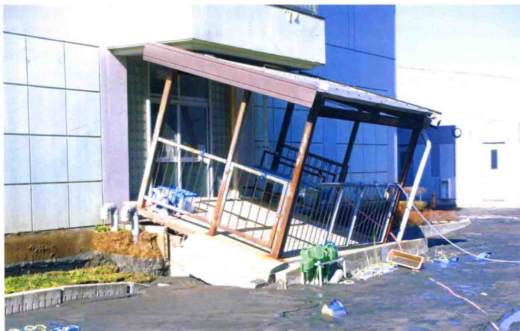
图 1-4-3 液化导致房屋沉降和倾斜
