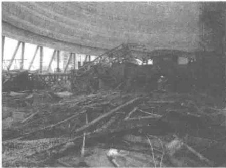
图 1.1-3 江西丰城电厂滑模垮塌事故
