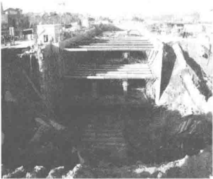
图 1.1-5 北京地铁基坑坍塌事故
