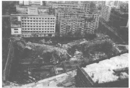
图 1.1-6 广州建筑基坑坍塌事故
