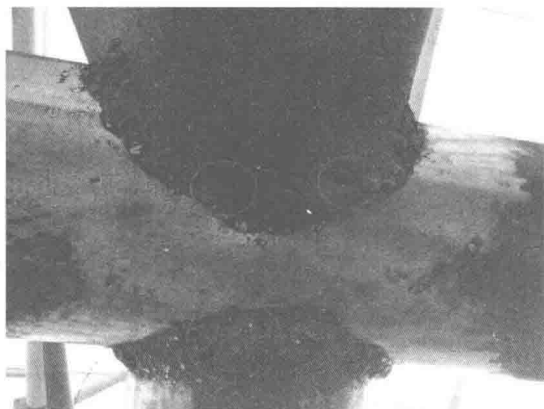
图 1-13 焊缝未焊透、气孔
