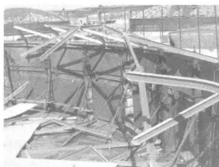
(b) 坍塌边部情况
