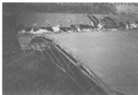
图 1-5 湖南耒阳电厂干煤棚倒塌实例
