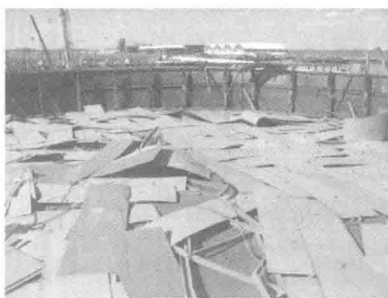
(a) 整体坍塌现场
