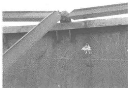
(e) 支座节点破坏情况一
