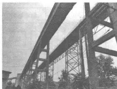
(d) 交通运输设施（原生产配套） 某水泥厂运输系统
