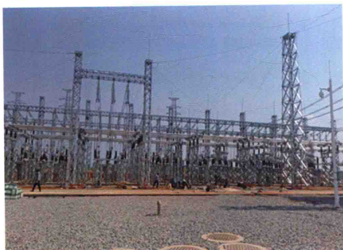
安哥拉sk输变电项目
