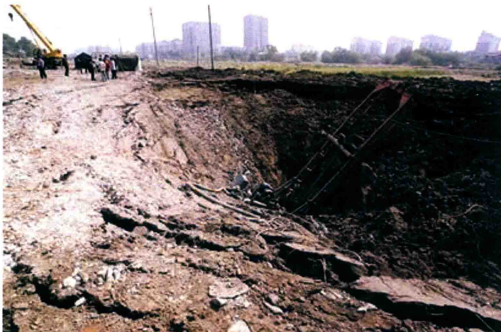
图片三 2011年5月6日,武汉市洪山区红旗村塌陷:钻机陷入塌陷坑中(刘大家 摄)
