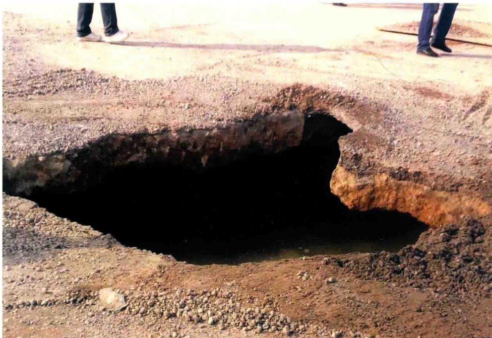
图片七 2016年2月25日,武汉市江夏区大桥新区红旗村东方明许,发育在混凝土路面下方的岩溶地面塌陷坑(樊永生 提供)
