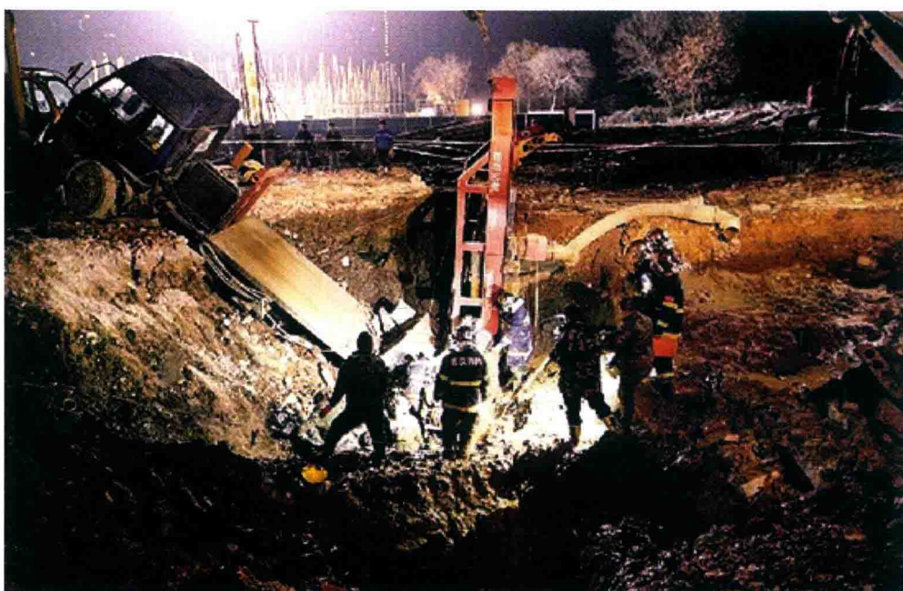
图片四 2013年12月26日,武汉市汉阳区拦江路岩溶地面塌陷:卡车和钻机陷入塌陷坑中(程思成 摄)
