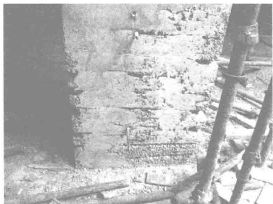
图 1-3 现浇钢筋混凝土柱蜂窝、露筋、缺棱掉角
