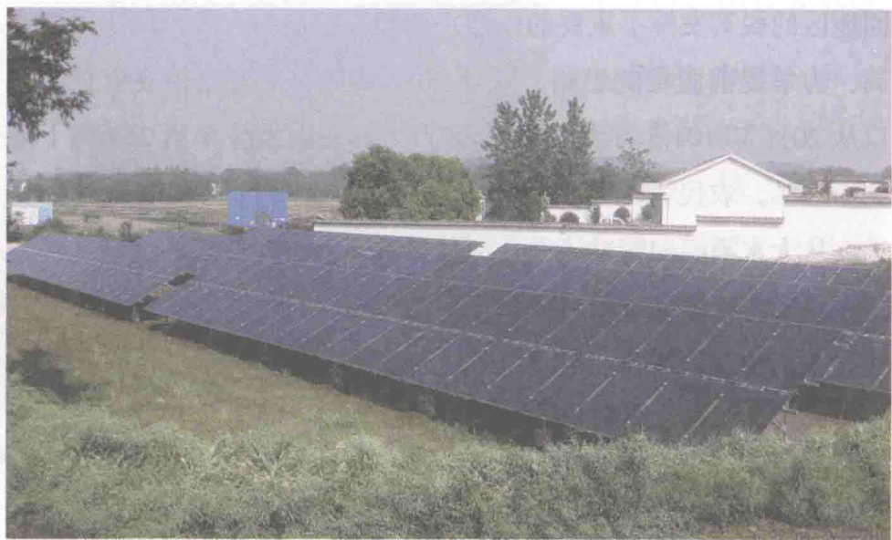
■ 转水湾村 60 千瓦光伏电站
