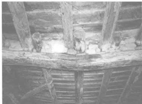
图 1-12 木构件白化、腐朽现象
