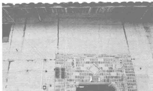
图 1-3 夯土墙的竖向通缝
