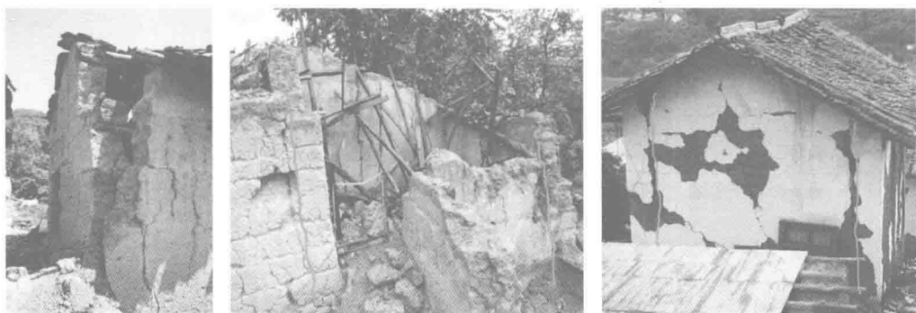
图 1-7 夯土民居破坏情况(墙内未设构造柱)
