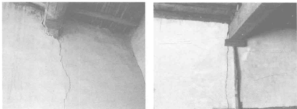
图 1-8 墙体局部受压承载力不足
