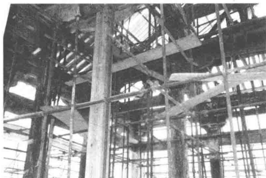
图 1-6 后期修缮中被添加上的支撑构件 (山西长治成汤王庙)
