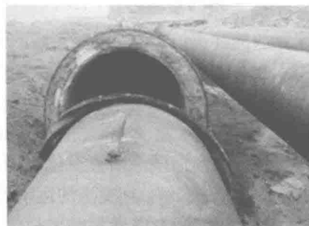
(d) 管道内壁的空蚀
