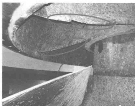
(a) 水轮机叶毂空蚀情况
