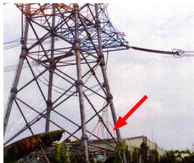
图1-4 导线跳线掉线
