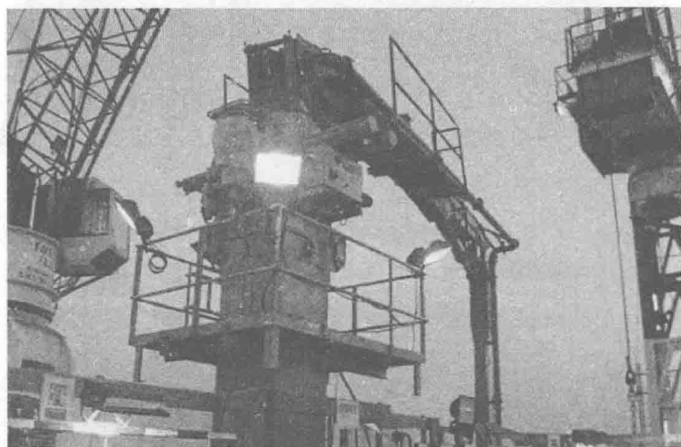
图 1-8 哈利法塔用混凝土制作设备
