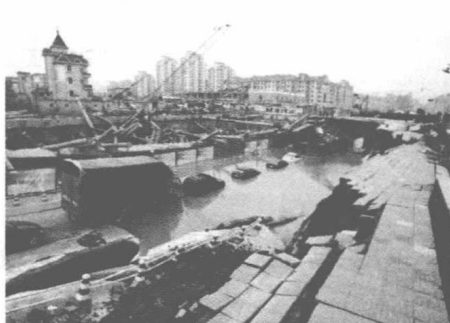
图 1.1-4 杭州地铁基坑坍塌事故
