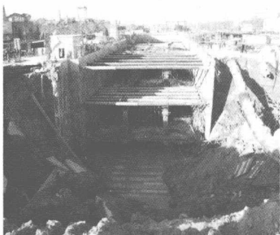
图 1.1-5 北京地铁基坑坍塌事故
