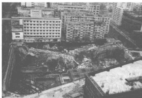
图 1.1-6 广州建筑基坑坍塌事故
