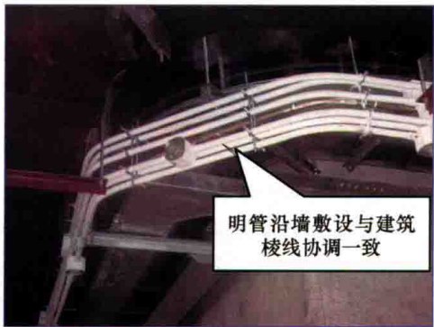
图 4.2-2 成排导管与槽盒及设备管道绕墙明敷设，排布合理，协调一致
