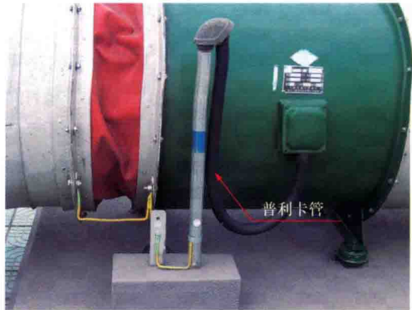
图 2.1-2 屋面采用防液型金属软管
