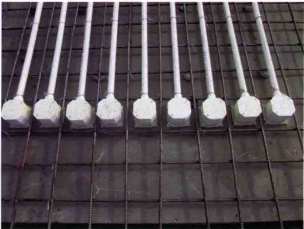
图 4.4-1 楼板上集中的成排接线盒排列整齐
