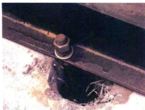
图 1-7 预留孔中心线定位偏差过大
