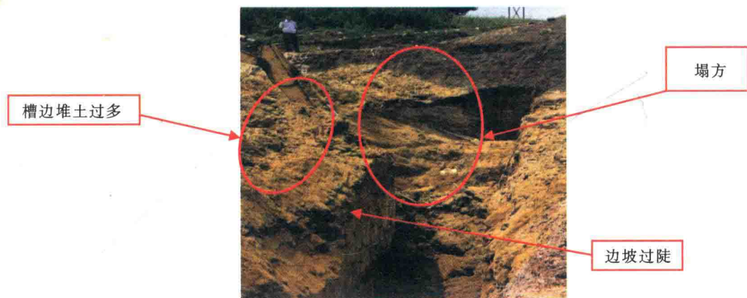
图 1-5 在挖槽过程中或之后,边坡土方局部或大部坍塌或滑坡
