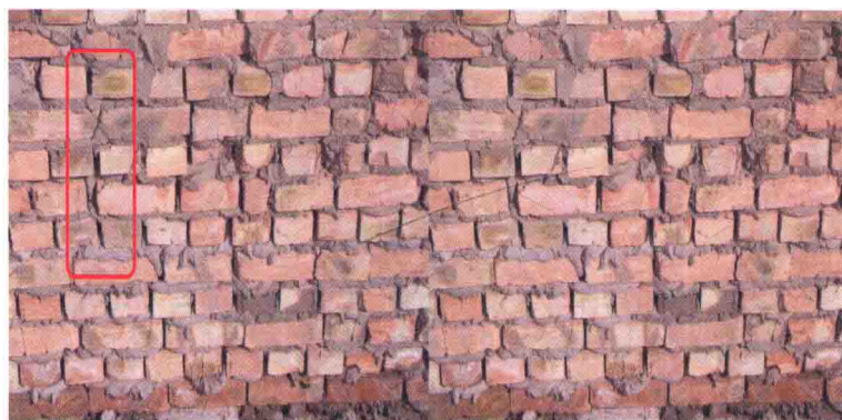
图 1-13 砖砌体组砌方法不正确造成墙面多处通缝
