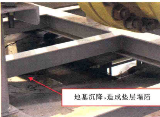
图 1-4 混凝土垫层塌陷
