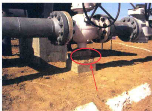
图 1-9 阀体混凝土支墩标高误差过大
