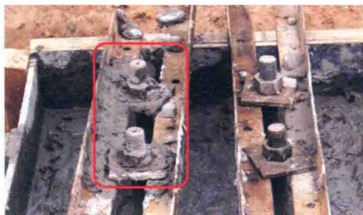
图 1-11 角钢固定不牢,且方型垫片应固定在角钢上
