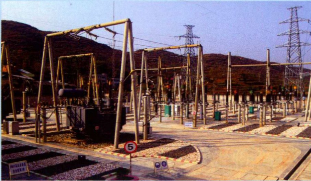
施秉县110KV变电站
