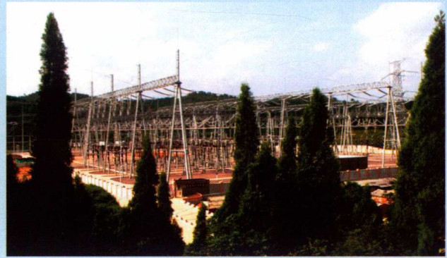
西电东送的重要支撑点之一——施秉500KVA变电站
