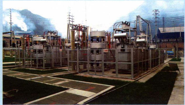
七里冲工业园区220KV变电站
