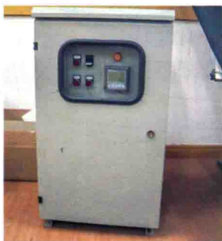
池塘水质监控控制柜
