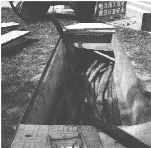
图 1-3 电缆沟中的电缆布局
