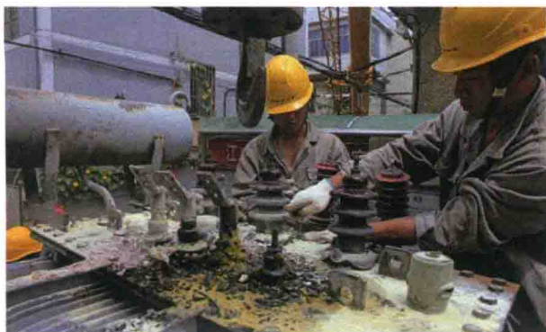
图 1-6 变压器中性点烧毁
