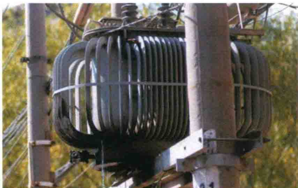
图 1-3 外渗漏油的配电变压器
