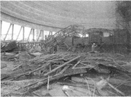
图 1.1-3 江西丰城电厂滑模垮塌事故
