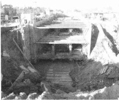
图 1.1-5 北京地铁基坑坍塌事故
