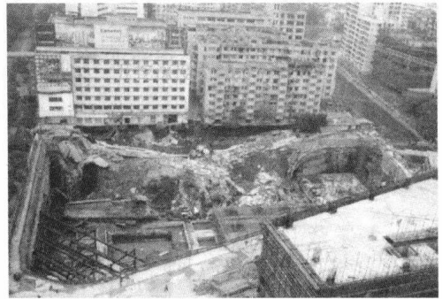
图 1.1-6 广州建筑基坑坍塌事故
