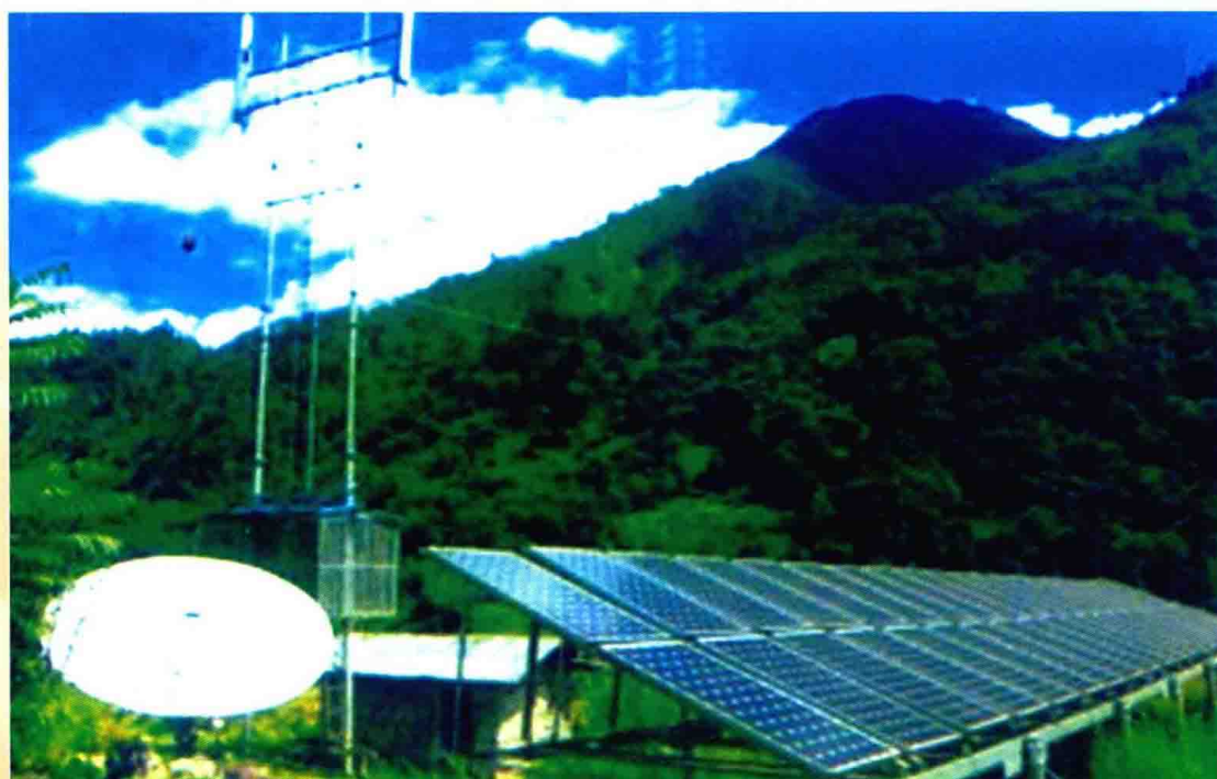
离网式太阳能移动基站系统
