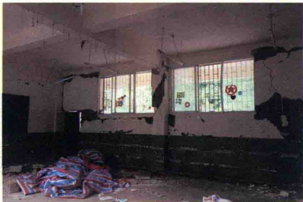
照片 2.14 鲁甸中学—开窗洞填充墙形成的短柱
