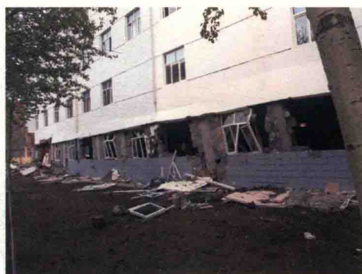
照片 2.19 玉树武警某框架底层沿纵向侧移
