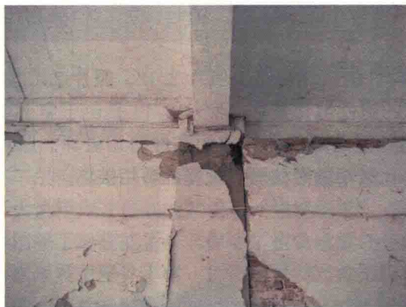
照片 2.7 无临空面节点一柱端出现塑性铰
