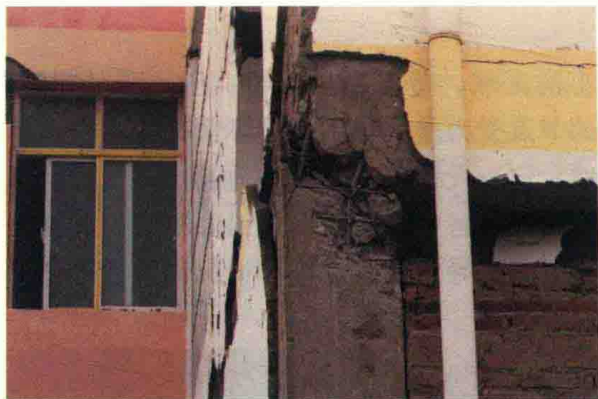
照片 2.11 填充墙推挤造成的节点破坏
