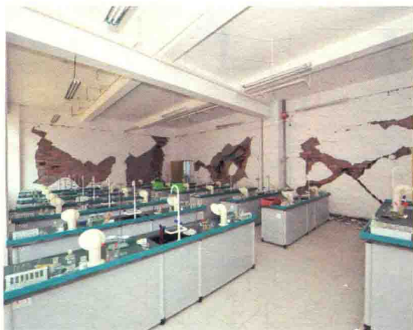
照片 2.1 芦山中学实验室多孔砖填充墙损坏
