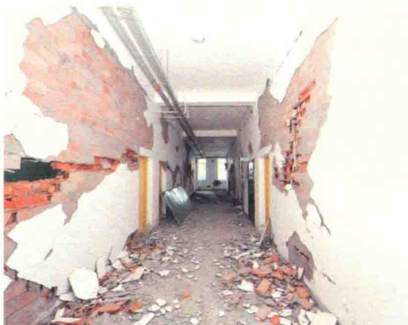
照片 2.2 芦山中学教学楼走廊填充墙破坏
