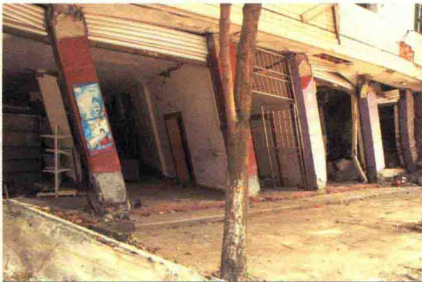
照片 2.17 框架底层纵向倒塌
