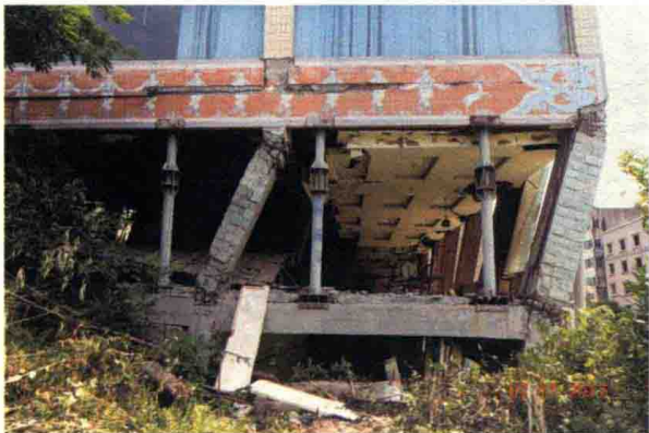
照片 2.16 北川大酒店第二层纵向倒塌
