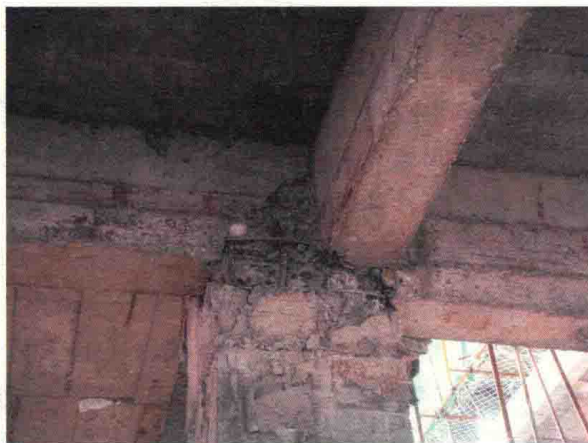
照片 2.8 无临空面的节点破坏
