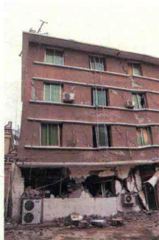
照片 2.13 汶川县底商破坏— 开窗洞填充墙形成的短柱
