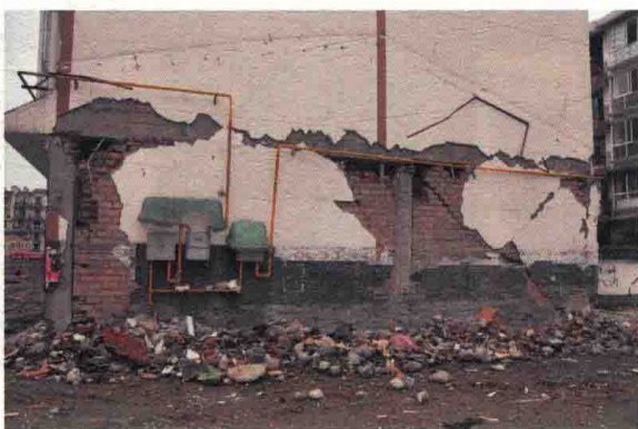
照片 2.10 角柱节点破坏
