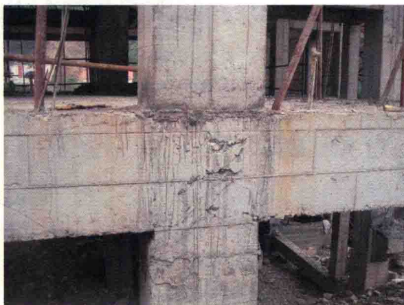
照片 2.6 北川禹荷花园框架节点核心剪切破坏
