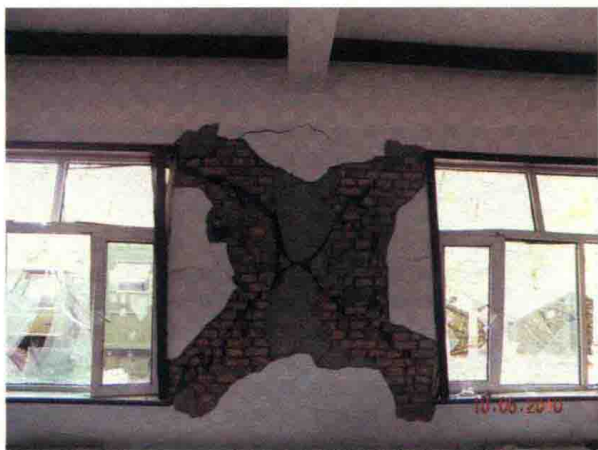
照片 2.12 短柱—剪跨比小的窗间墙
