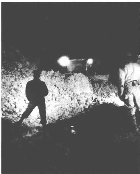
■ 工人们在夜间加班加点赶修公路，点燃了的柴油桶是他们的照明工具。
