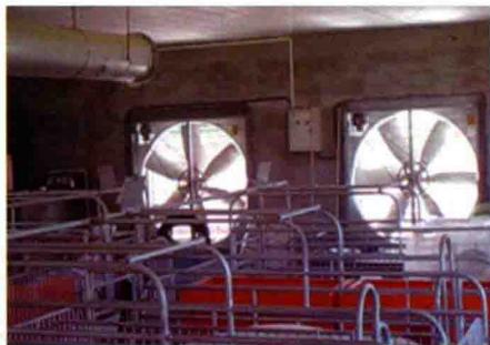
彩图 6-5 产房通风换气设备
