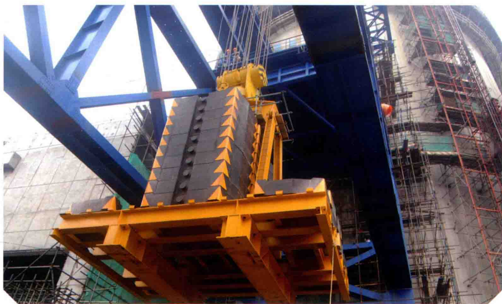
▲ 2号机组380 t龙门吊可用
