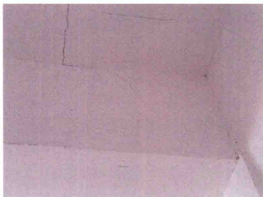
图 1-13 承重横梁上有裂缝
