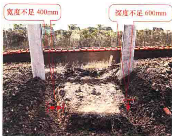
图1-3-1 接地网沟槽错误开挖案例图
