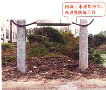
图1-2-5 配电变台基础塌陷案例图
