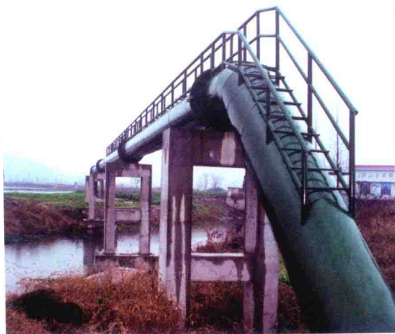
DN800输水管桥
