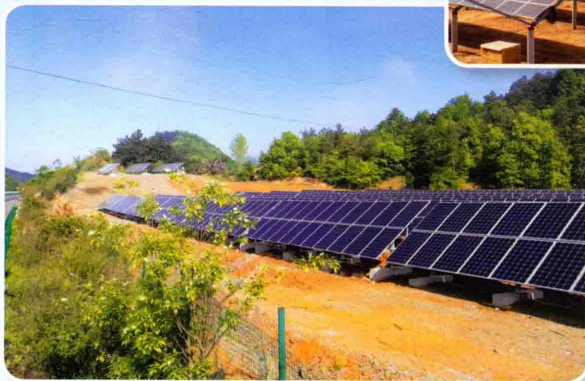
安徽省金寨县古碑镇集成式光伏扶贫电站。
