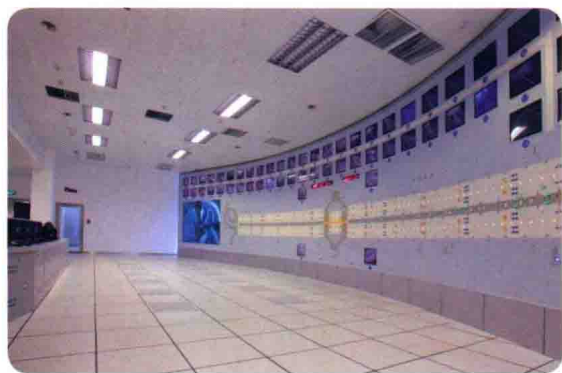
综合监控管理大楼中央控制室
