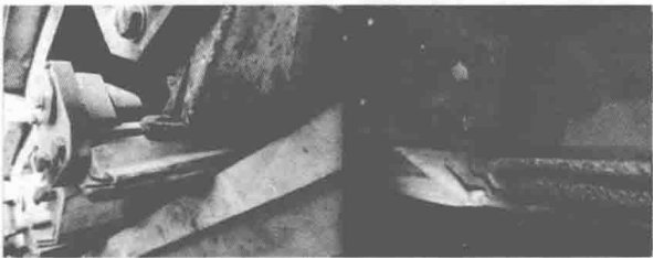
图 1 膨胀接头烧蚀情况
