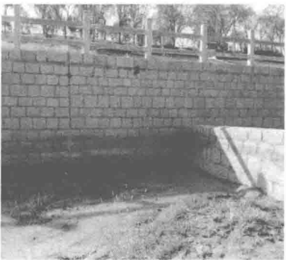
图 2-8 潘庄引黄闸闸后渗水细部
