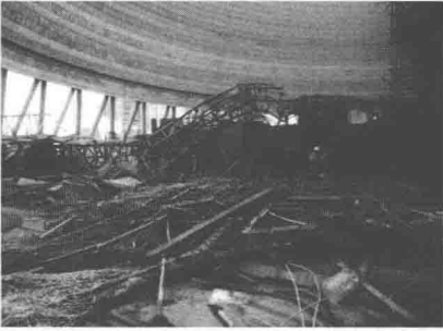
图 1.1-3 江西丰城电厂滑模垮塌事故
