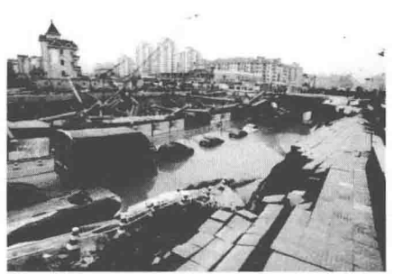
图 1.1-4 杭州地铁基坑坍塌事故
