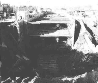
图 1.1-5 北京地铁基坑坍塌事故
