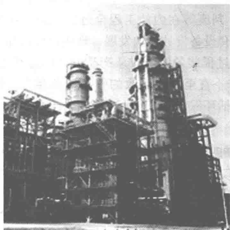
图 1-2 常减压装置整体设备
