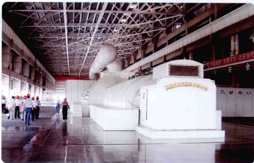
国电黄金埠发电有限公司一期 2 \times 650\text{MW} 并网发电机组。
