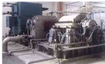
大型LNG装置用压缩机
