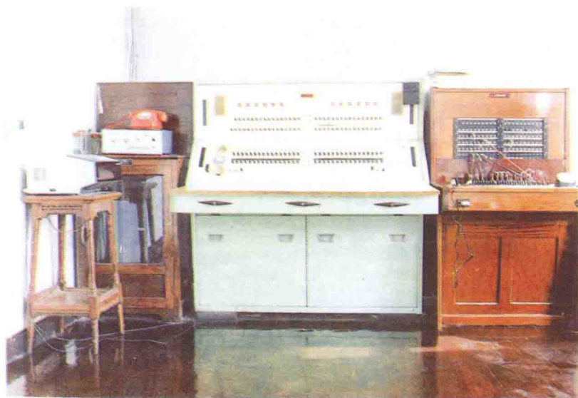
7. 100 门有线通讯机房
