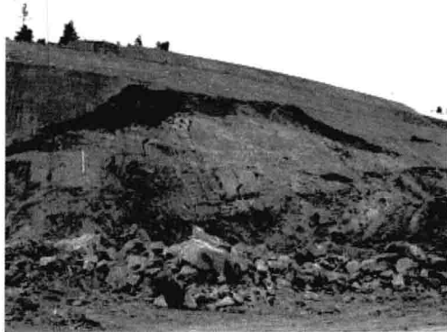
图 1-7 开挖边坡滑坡
