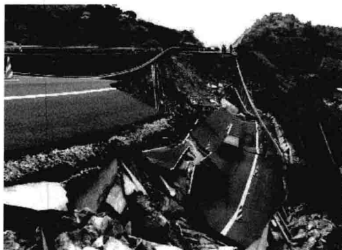
图 1-9 路堤边坡滑坡
