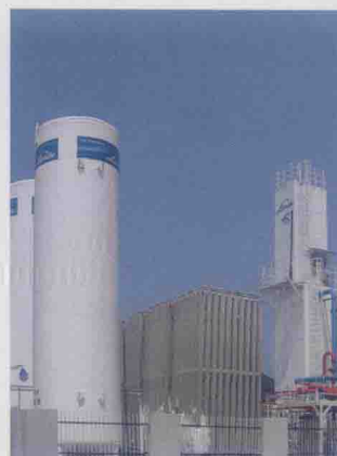
林德新安GAN2000m 3 /h 高氮装置
