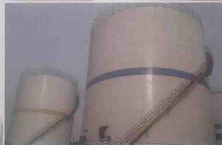
■ 2000m 3 大型平底贮槽
