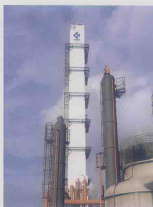
美国APCI公司淄博项目200t/d 液体装置
