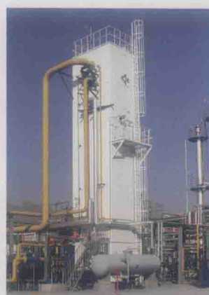
磴口30万m 3 /d LNG装置
