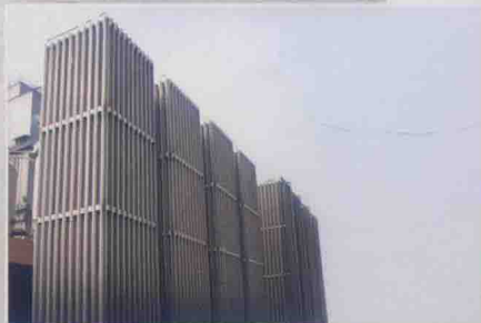
■ 沙钢现场8台6250m 3 /h大型汽化器
