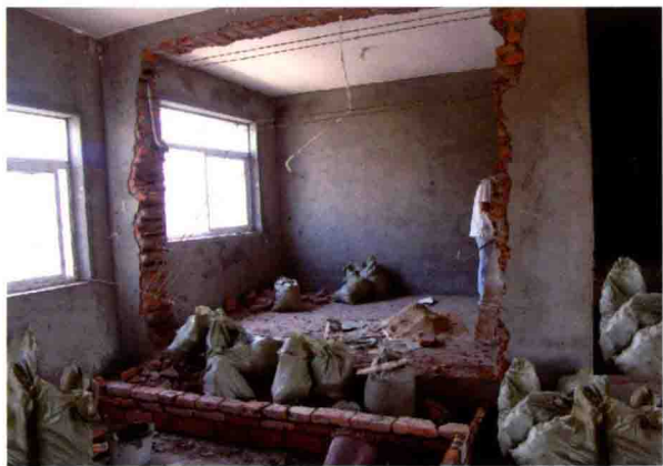
图 1-8 危险的拆墙开门洞
