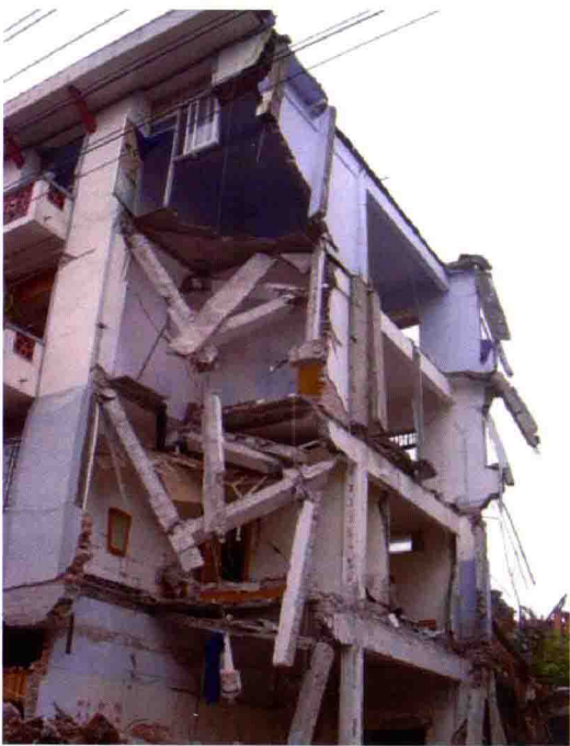
图 1-3 某砖混结构房屋震后状况
