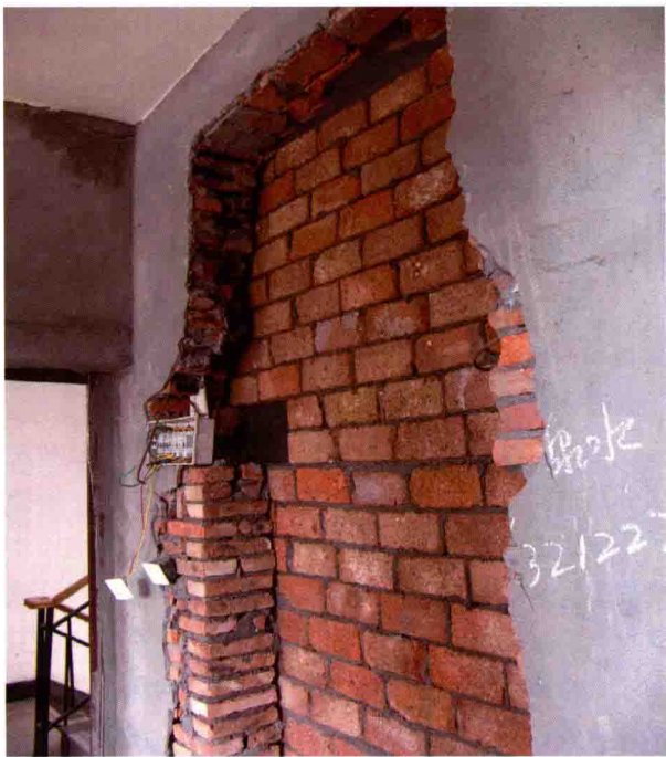
图 1-14 做大壁柜对墙体的损坏
