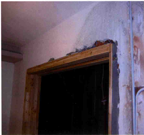
图 1-12 安装门套对墙体的损坏
