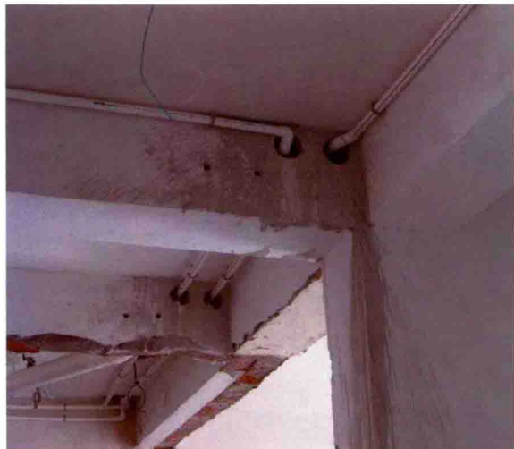
图 1-15 敷设管线对梁体的损坏
