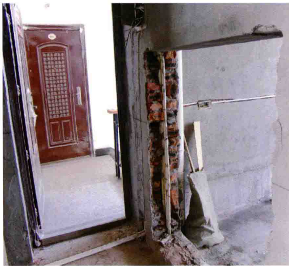
图 1-13 做进门鞋柜对墙体的损坏
