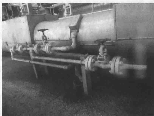
图 4 燃油添加剂进重油管道的接点
