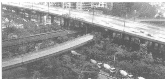
图 1-7 引桥下地面沉陷出一个窟窿
