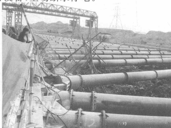
图 1-8 支撑稀少部位的围护结构垮塌
