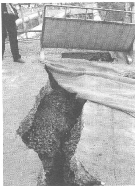
图 1-2 基坑旁的道路裂开
