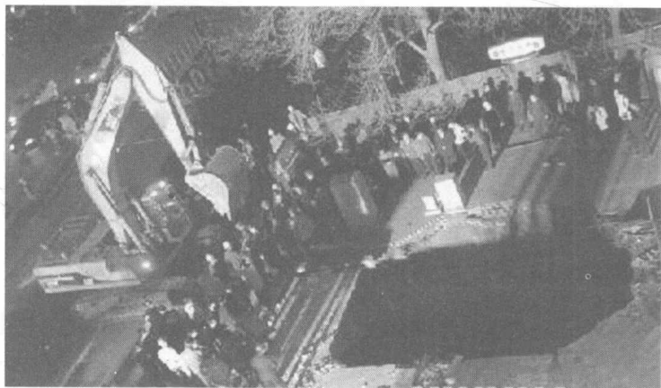
图 1-4 地面塌陷一大坑
