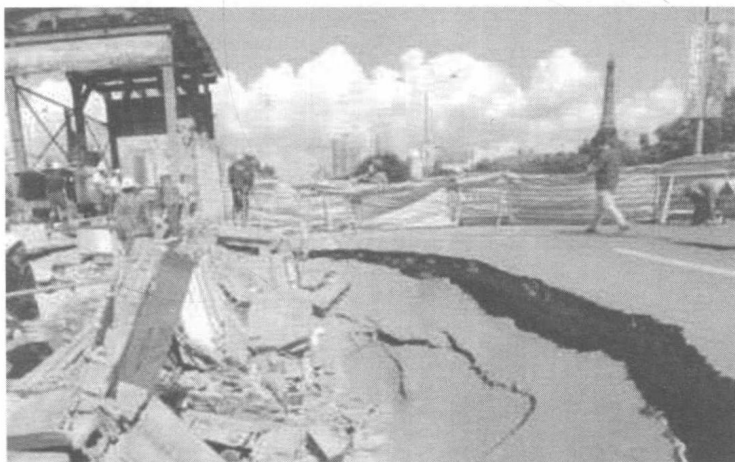
图 1-3 地面出现裂缝
