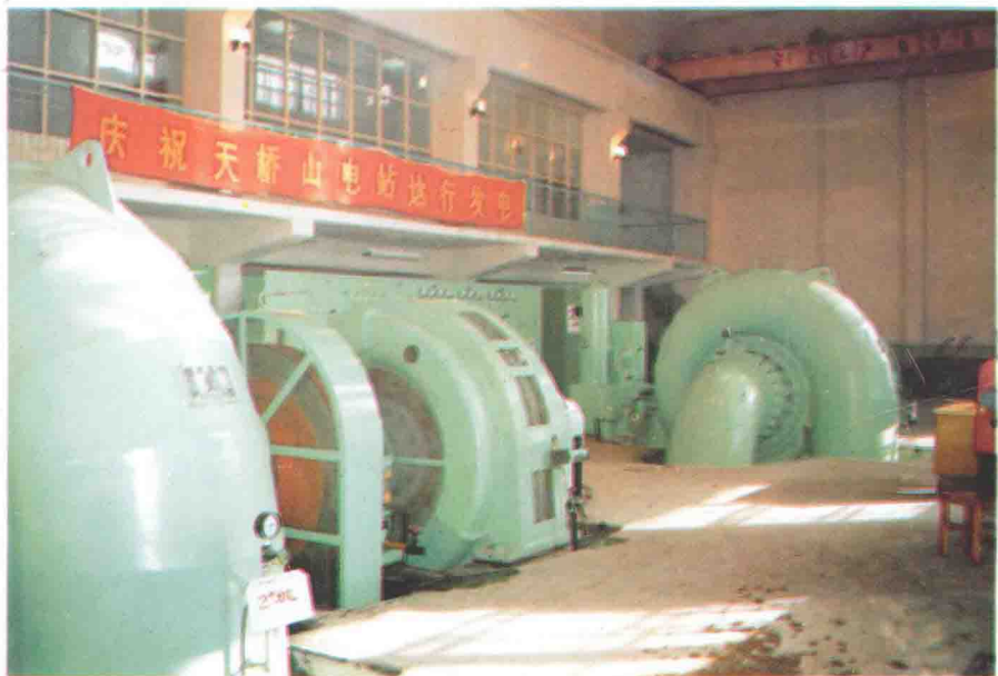
天桥山水电站机房
