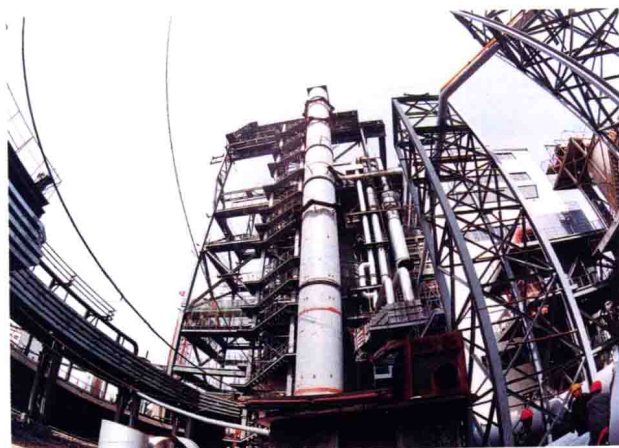
通钢干熄焦工程
